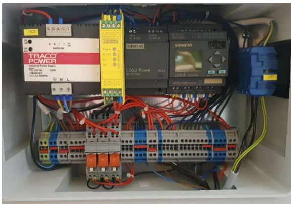
Abb. 4-1 fertiggestellte Verdrahtung - Foto: M. Reitinger
