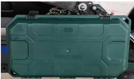
Abbildung 31: Schaltkasten links außen
