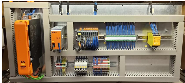
Abbildung 2: Schaltschrank nach Fertigung
