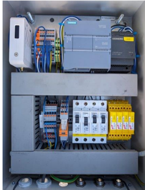
Abbildung 4: Schaltschrank mit Steuerung und Peripherie
